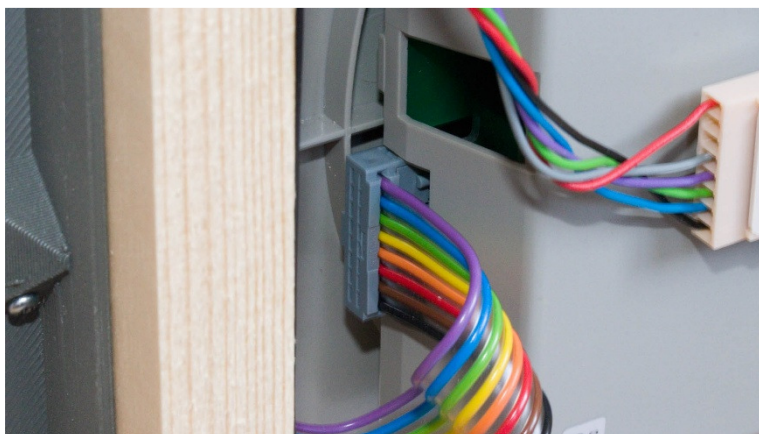
Abbildung 15: Anschluss des Bandkabels an die Drehscheibe
